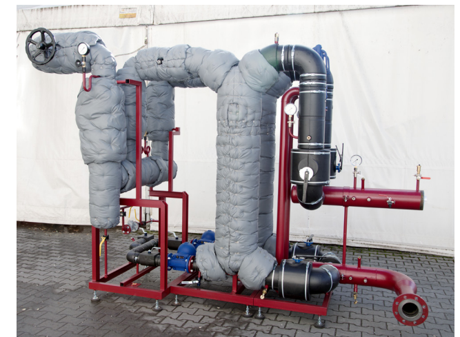
Přerov - Precheza - izolace technologie SYMPATIK, primární parní médium a trubkový výměník v technologii FLEXIZOL T, sekundární strana izolována v technologii DH BOX
